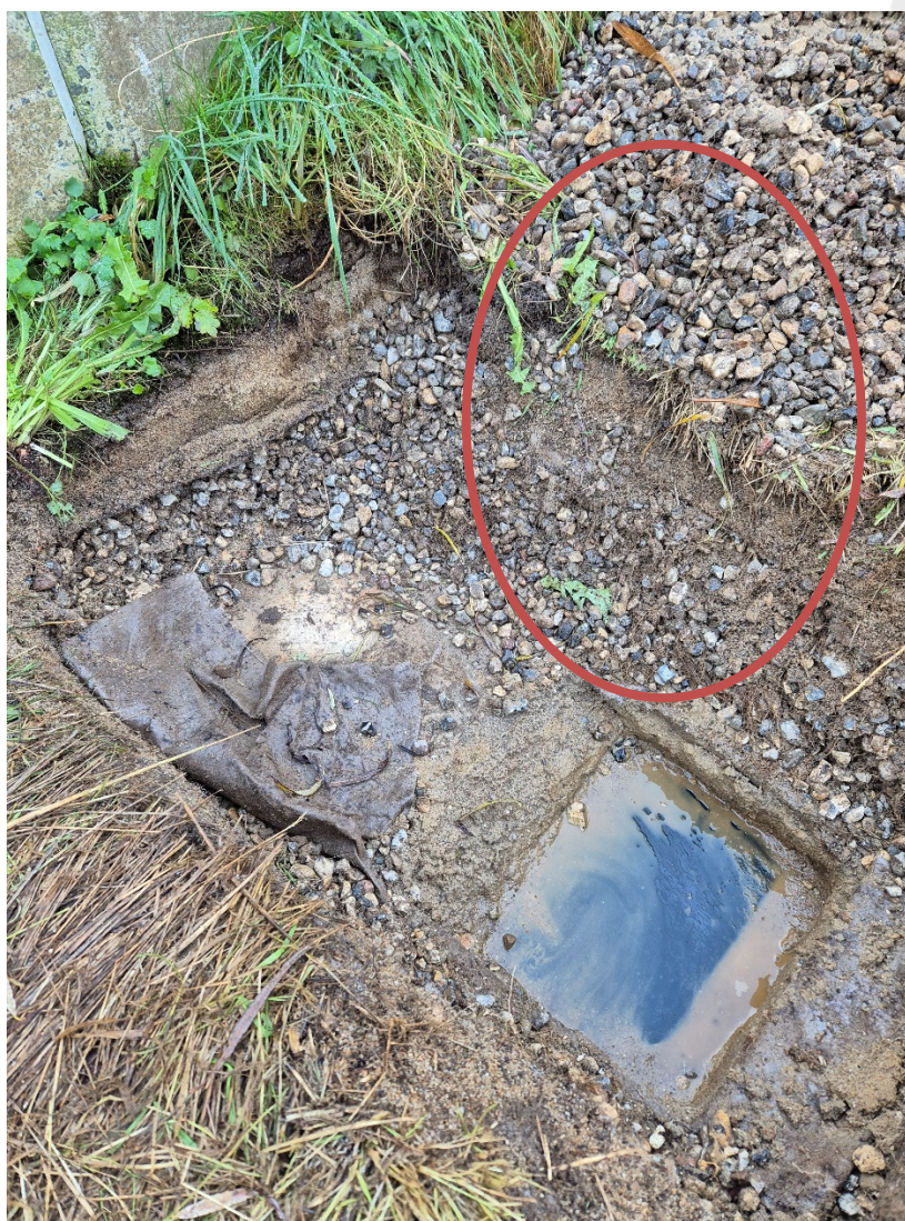
Billede 2 - Der ses på billedet en større mængde rødder der går igennem første fiberdug og rallaget. Rødderne stopper umiddelbart i den nederste fiberdug, dog ses der enkelte små rødder i toppen af sandlaget. Rødderne ses primært i den runde cirkel.
