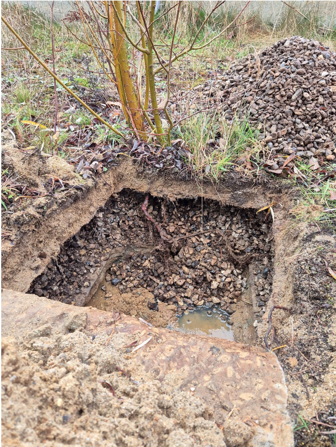
Billede 4 - På billedet ses det hvordan rodnettet fra et større piletræ (ca. 1,5 m) gennemborer den øverste fiberduk og rallaget med en større rod. Det ses også, at roden afbøjes på den nederste fiberduk og ikke gennembryder denne udover med mindre hårfine rødder. Der ses ikke væsentlig rodpåvirkning af det nederste sandlang.
