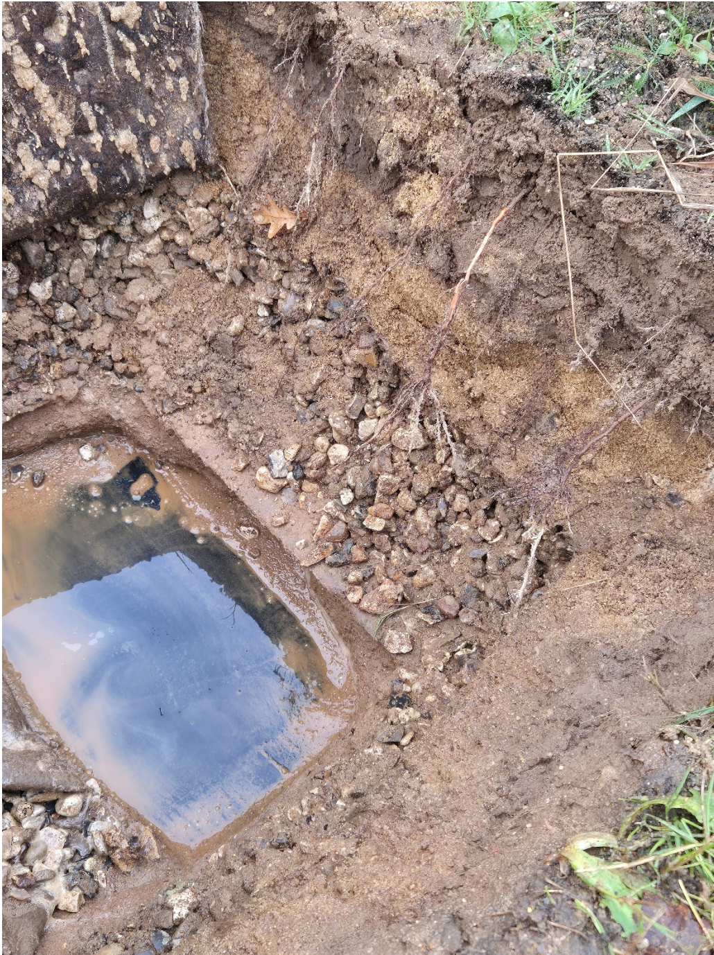
Billede 3 - viser rodnettet fra et ca. 1 m højt grantræ. Der ses ikke en tydelig påvirkning af den øverste fiberdug herfra. Rallaget fremstår også uden væsentligt rodpåvirkning. Øverst i billedet ses den øverste fiberdug, denne fremstår ikke uden væsentligt ge
