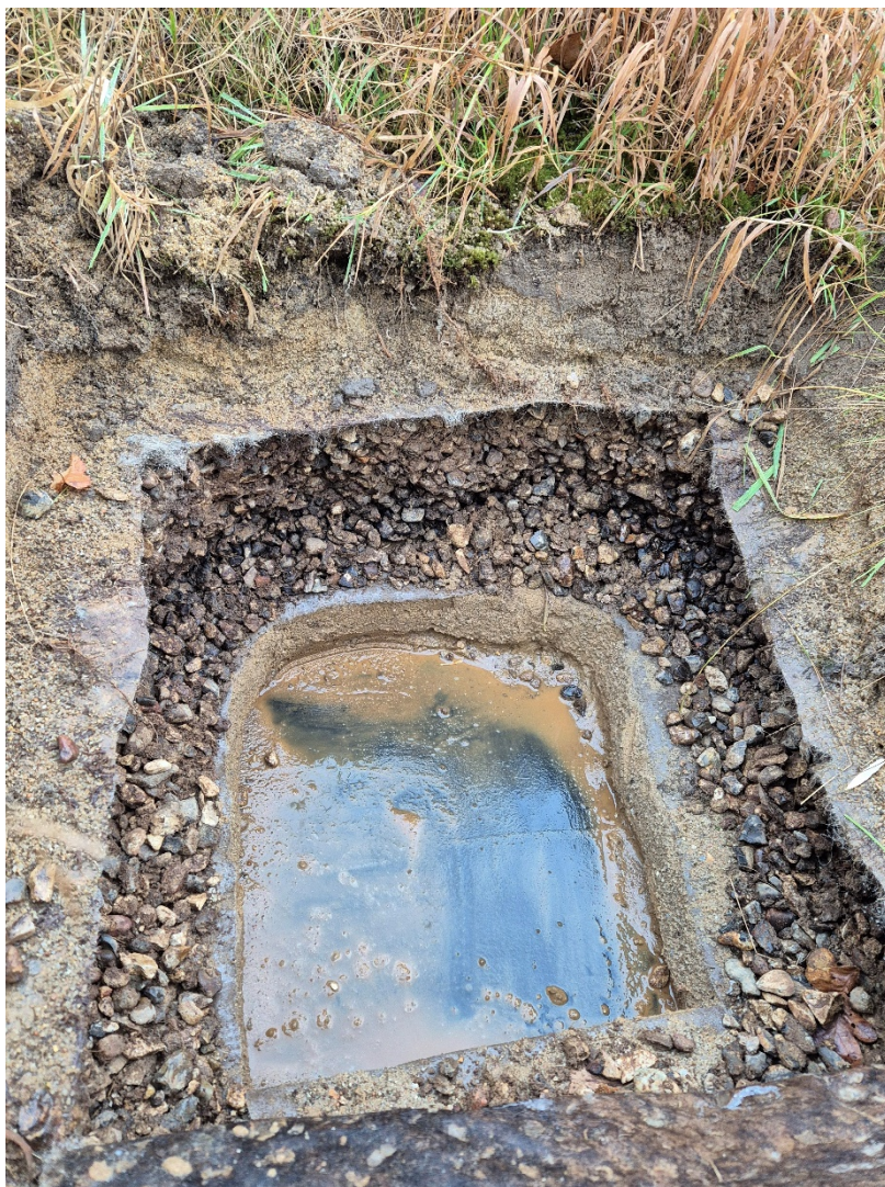
Billede 1 - Viser opbygningen af sandlageret med fiberdug, ral og membran. Bemærk at der i dette hul ses begrænset rødde under første fiberdug.
