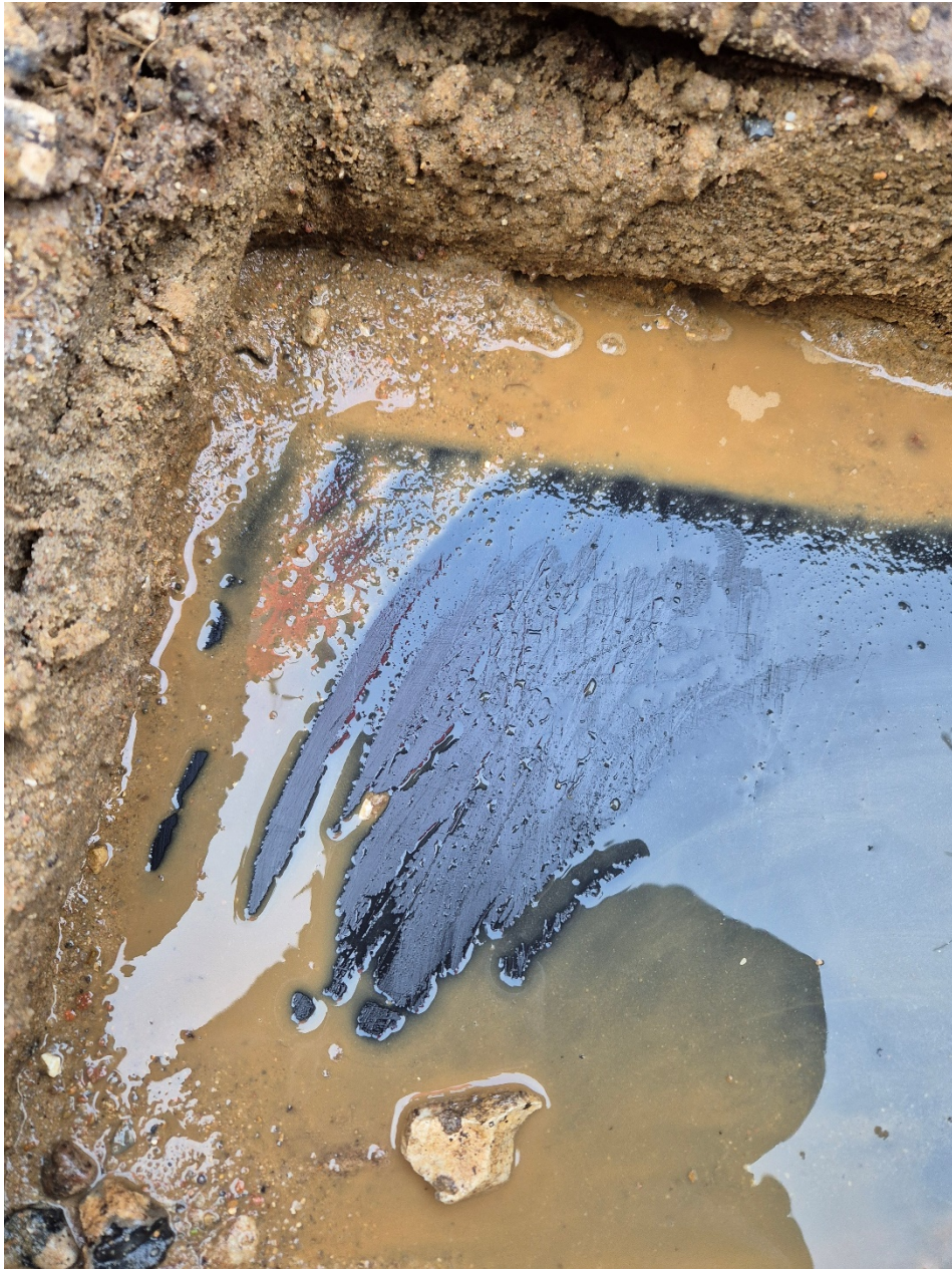
Billede 5 - Billedet viser tilstanden af gummi/plastik membranen i bunden af bassinet. Membranen fremstår glat og hård, uden tydelige tegn på nedbrydning. Membranen fremstår umiddelbart i samme tilstand i alle de besigtigede huller.
